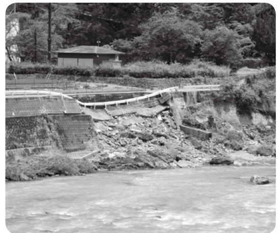
上越方の災害現場
