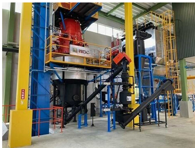
類似事例：木質バイオマスガス発電設備（株式会社南部町バイオマスエナジー）
