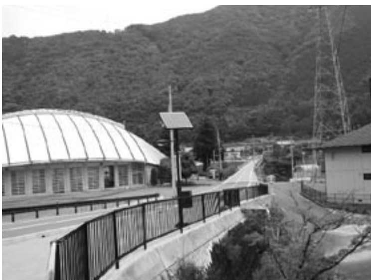
太陽光発電パネルの街路灯
