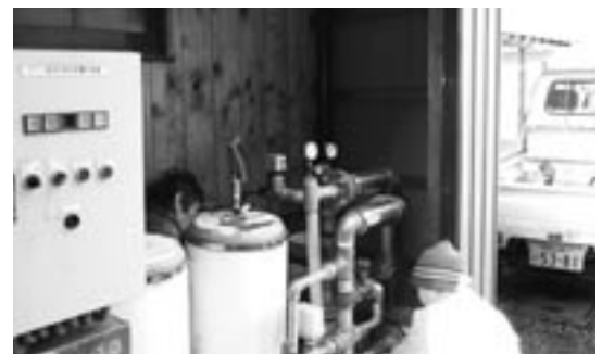
現在の愛徳荘のボイラー
