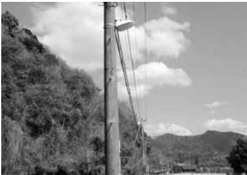
LED化された道路照明
