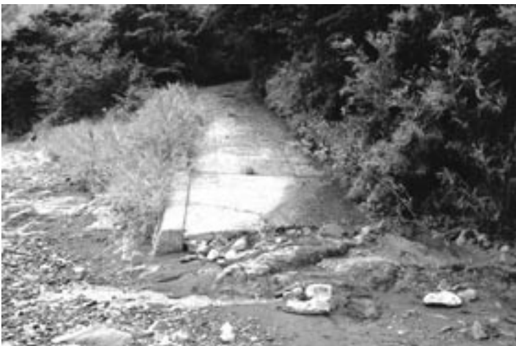
補修が必要な消防道路
