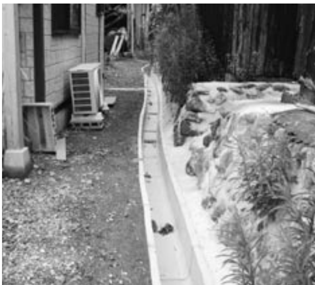
住民参加型排水路
