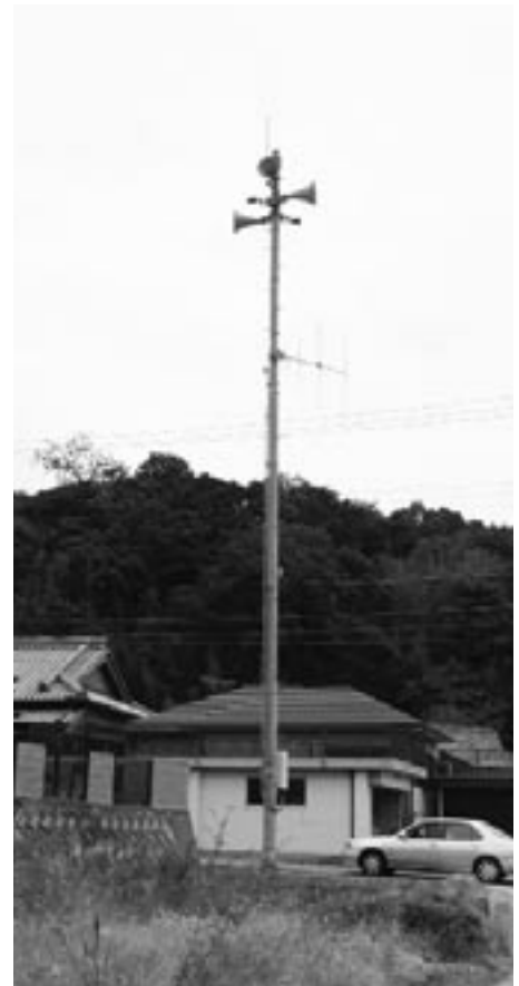
防災無線施設
