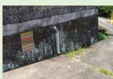
11:台風12号大水害 日高川最高水位
