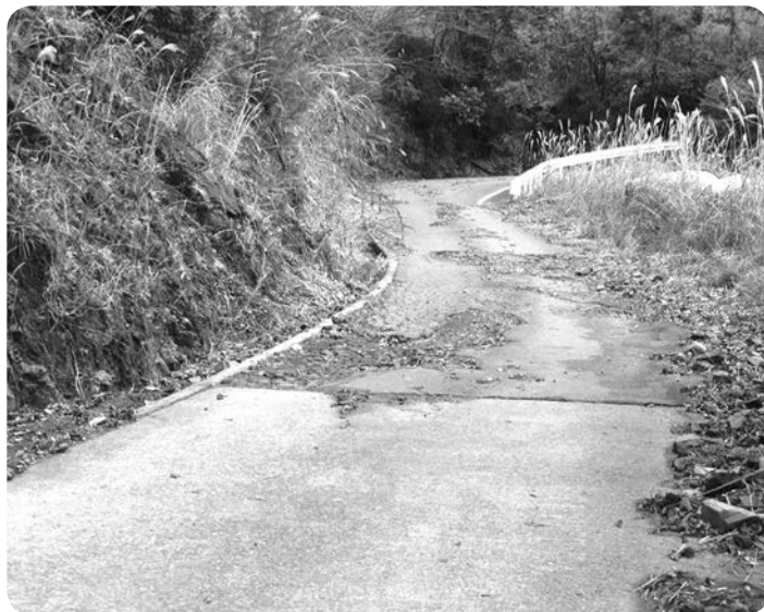
舗装や改良が待たれる林道
