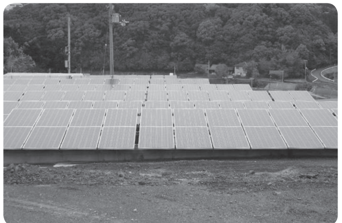
太陽光発電施設
