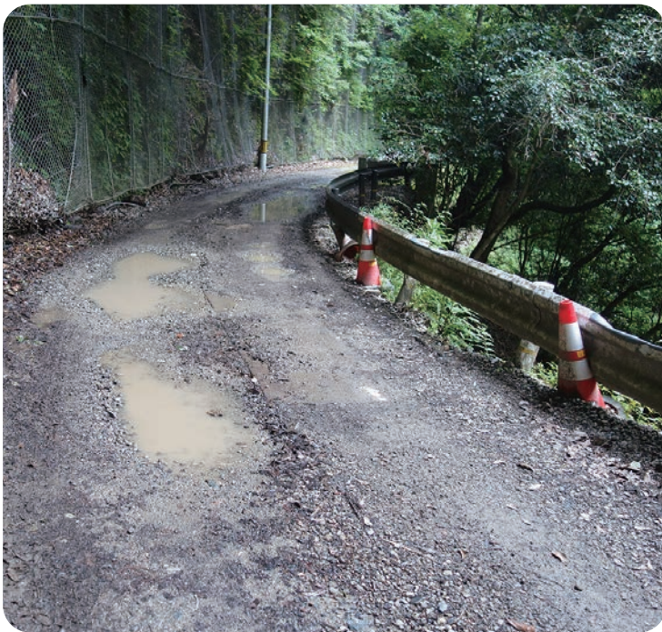
路側の欠損（寒川地内）
