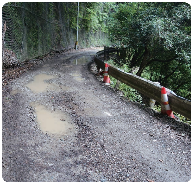
路側の欠損（寒川地内）
