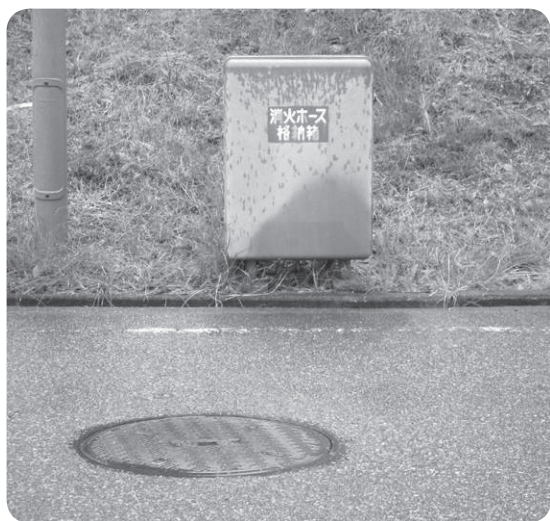
消火栓とホース等の格納箱
