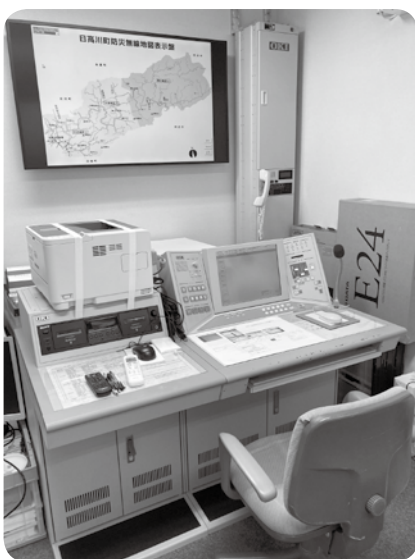
庁内の防災無線室
