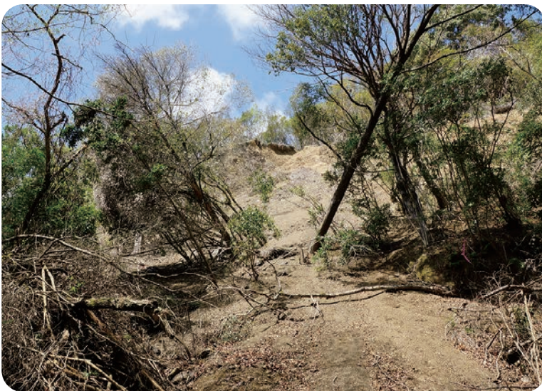
町道大又藤野川線道路災害現場
