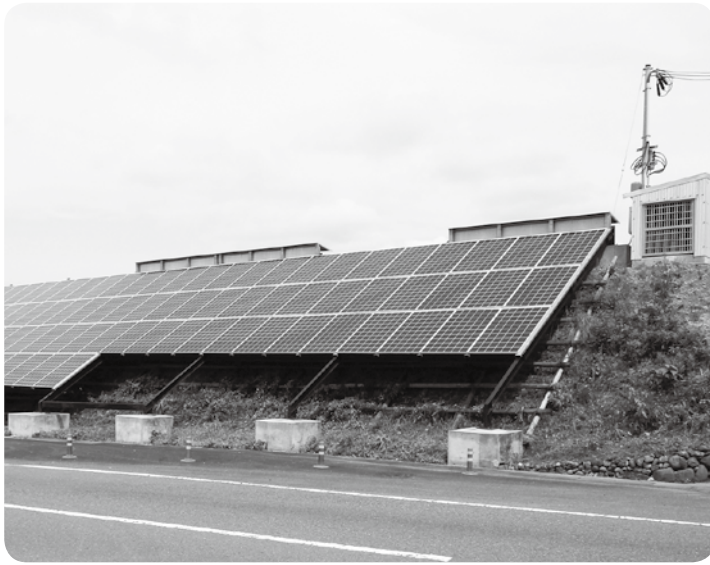
太陽光発電施設
