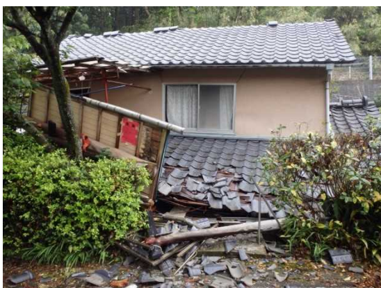
熊本地震の被災家屋（西原村）
